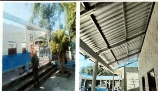
Foto 7: MODULO B Vista Frontal desmontaje de lamina de zinc en mal estado. Vista de corredor con estructura de metal y lamina troquelada cal 26.
